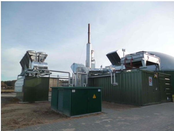
Anlage mit Blockheizkraftwerk (Foto Siggelkower Mooster GmbH)
