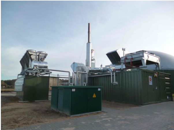
Anlage mit Blockheizkraftwerk (Foto Siggelkower Mooster GmbH)
