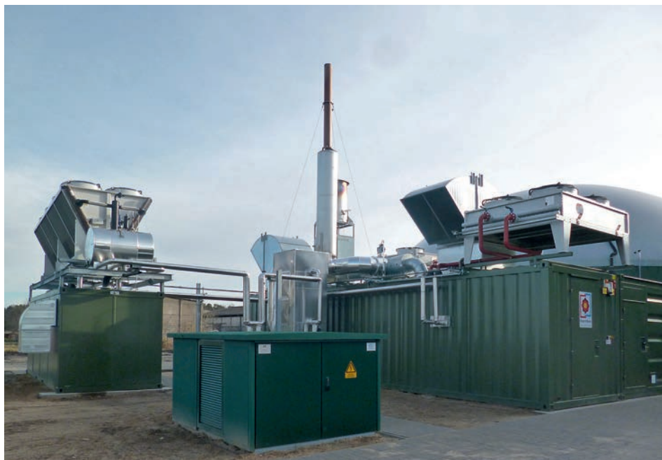
Anlage mit Blockheizkraftwerk und ORC-Anlage.
